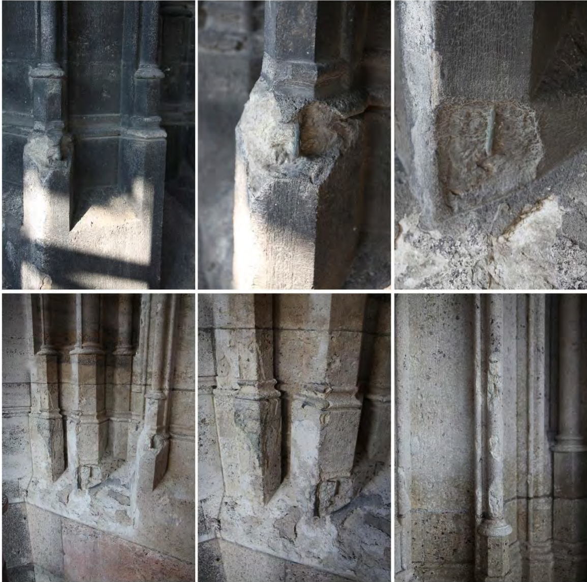
Schadensbild am Portal, Südturm der Votivkirche in Wien
